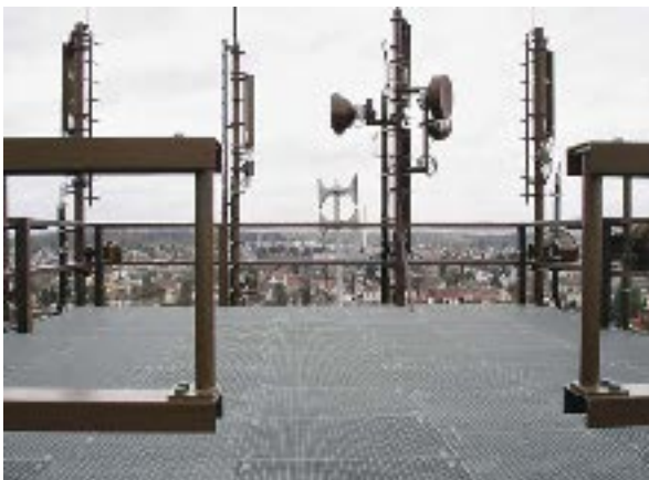
Richtstrahlantennen übertragen die Mobiltelefongespräche über die Dächer von Zürich.
