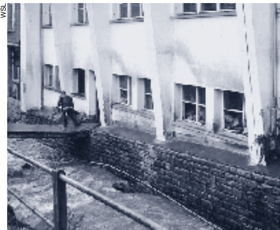
Fig. 1: Les dégâts visibles après le passage d'une crue importante.
