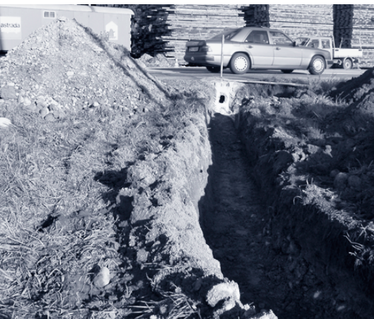
Abb. 3: Anschluss der Versuchsanlage an das Strassenabwasser
