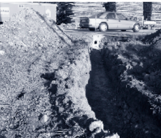
Abb. 3: Anschluss der Versuchsanlage an das Strassenabwasser
