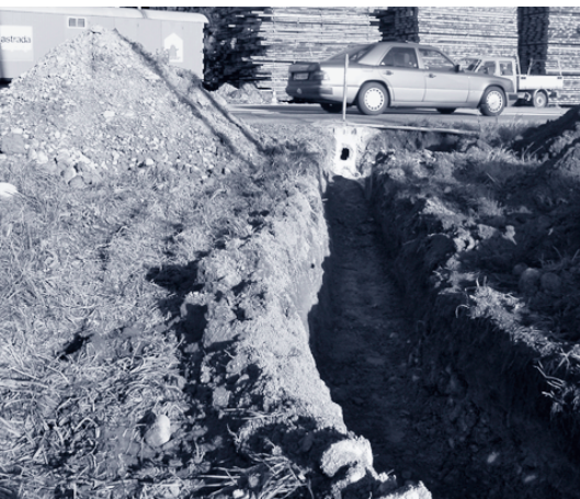
Fig. 3: Raccordement du dispositif expérimental au captage des eaux de ruissellement de la route.
