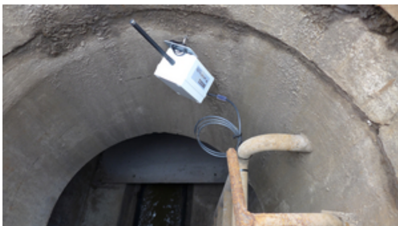
Pegelsensor im Abwasserkanal mit Funkübertragung (Foto: Frank Blumensaat, Eawag)
