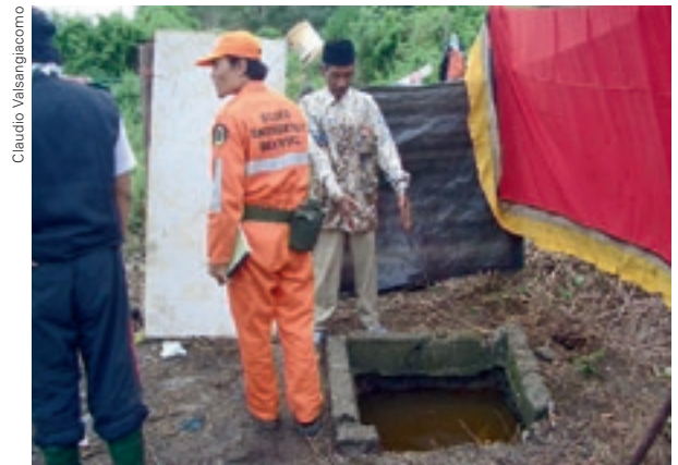
Zerstörter Trinkwasserbrunnen bei Aceh, Indonesien, welcher zur Instandstellung in Betracht gezogen wurde. Hinter der schwarzen Plastikplane befindet sich eine Grubenlatrine, die den Brunnen laufend verschmutzt.
