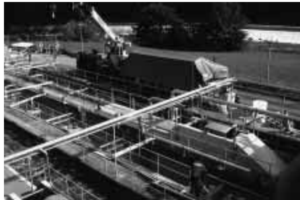
Abbildung: Blick auf die beiden Versuchsanlagen auf der ARA Laufäcker (Turgi, AG). Unter der im Hintergrund sichtbaren Abdeckung ist die halbtechnische Pilotanlage verborgen. (Foto: Max Maurer)
