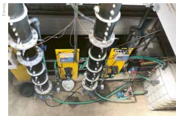
Pilotversuche zur GAK-Filtration auf der ARA Muri.
