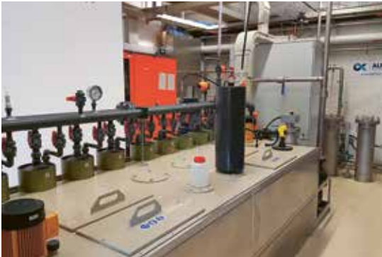
Les modules membranaires de l'installation de stripping de l'azote de la STEP d'Yverdon-les-Bains
