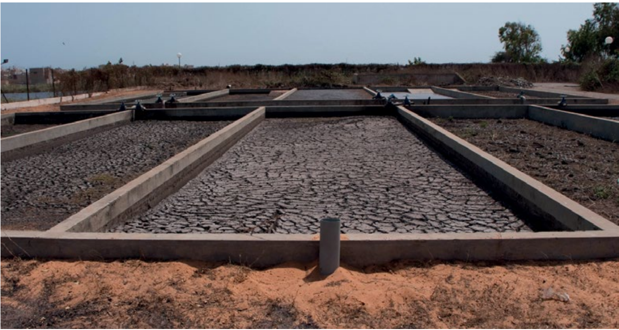
Figura 3.4 Lechos de secado sin plantas en la Estación de Tratamiento de Lodos Fecales Niayes, en Dakar, Senegal (foto: Linda Strande).
