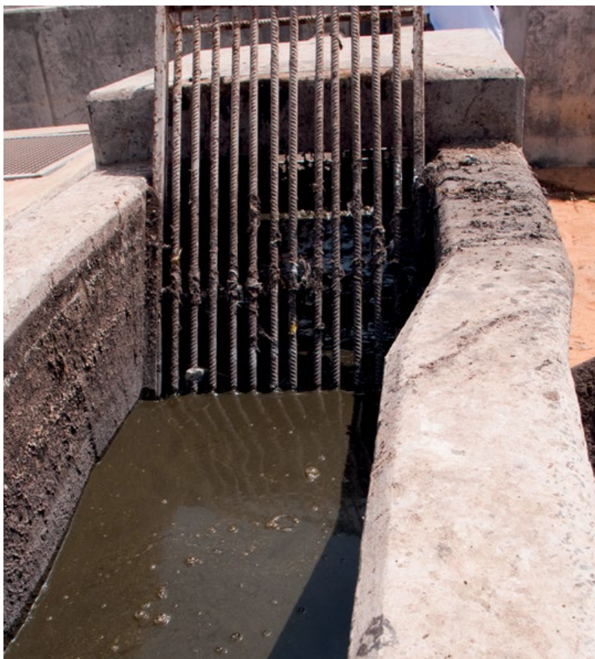
Figura 3.6 Tamiz de barras en la Estación de Tratamiento de Lodos Fecales Niayes, en Dakar, Senegal (foto: Linda Strande).
