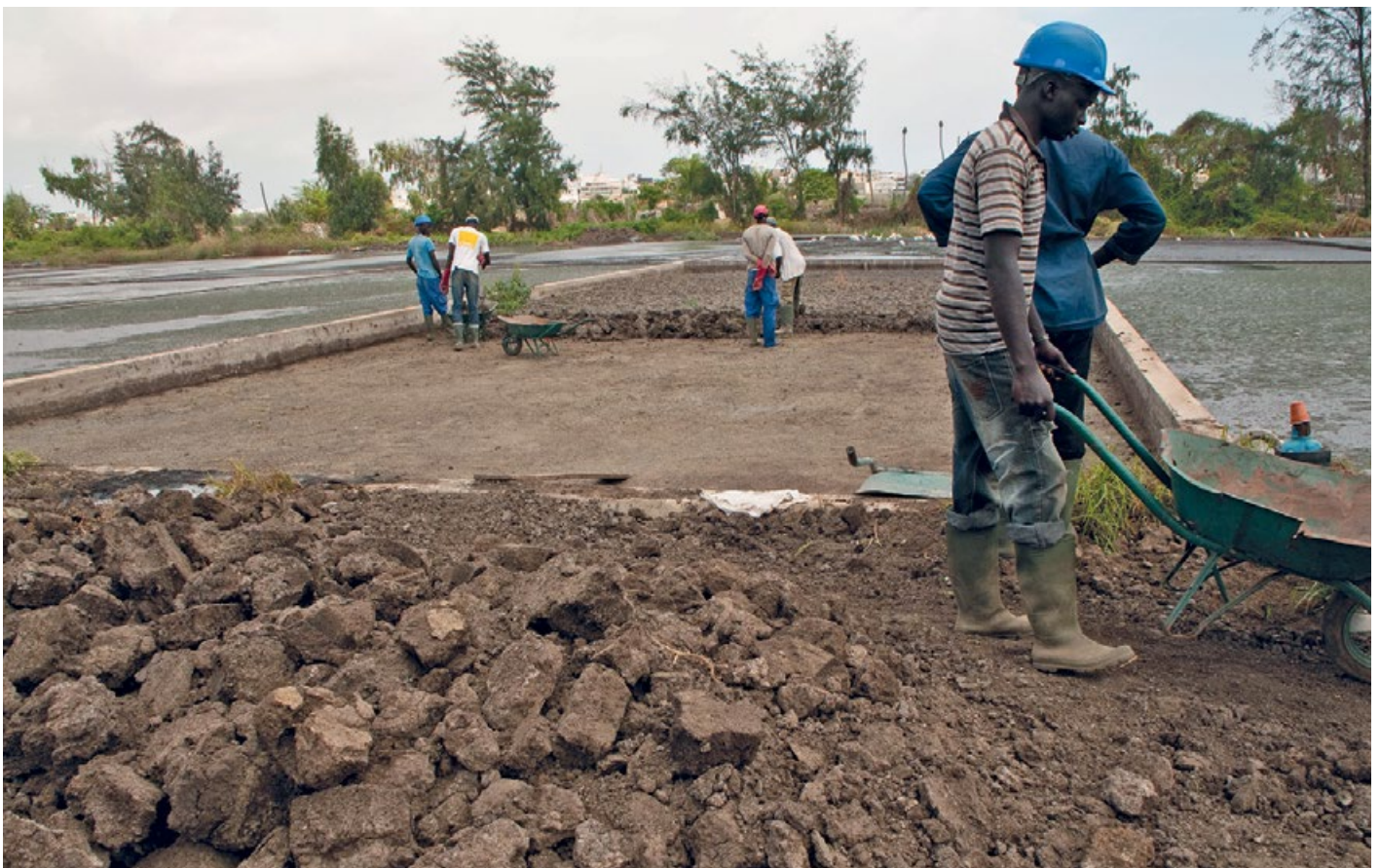
Figura 7.5 Extracción de lodos de los lechos de secado sin plantas en la Estación de Tratamiento de Lodos Fecales Cambéréne, en Dakar, Senegal. En primer plano, se observan los lodos ya sacados (foto: Linda Strande).
