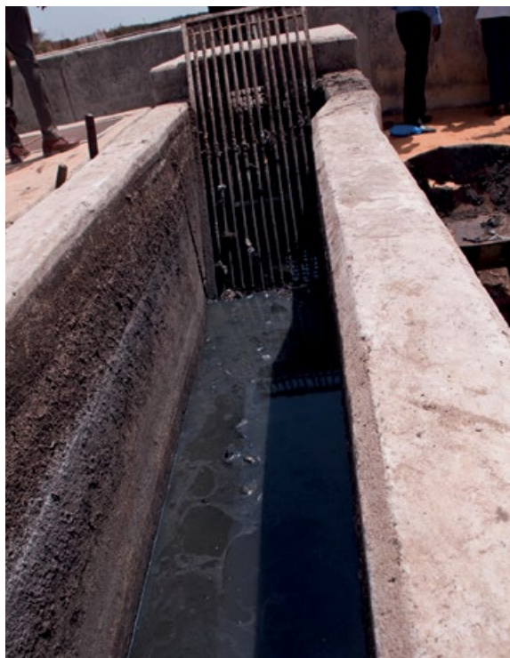
Figura 8.5 Tanque de almacenamiento y mezclado en Senegal, con un tamiz de barras para prevenir el ingreso de basura que podría atascarse en los equipos (foto: Linda Strande).
