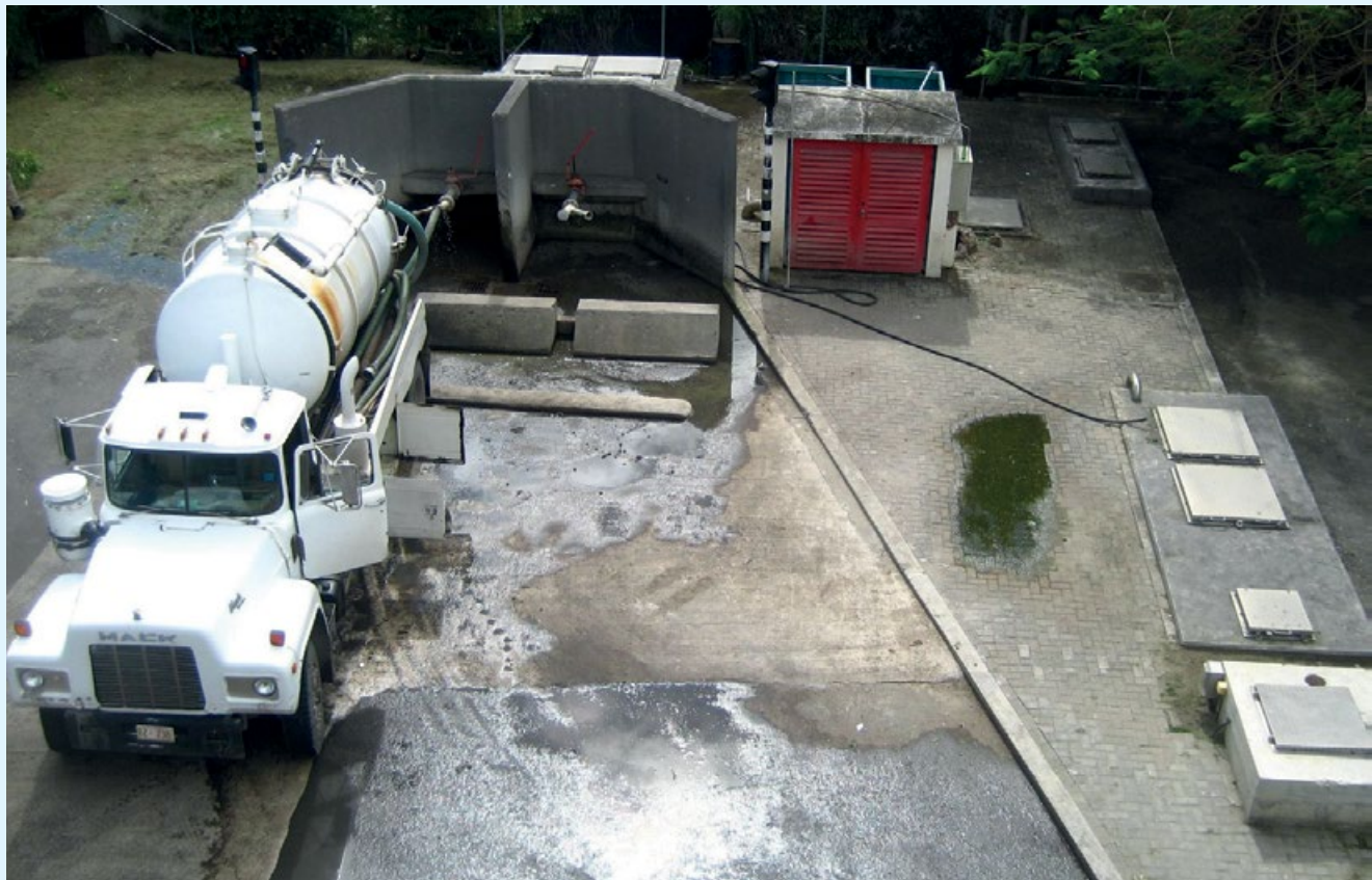
Figura 9.10 La entrada de lodos fecales al tanque de igualación de la EDAR de la Calle Illidge.
