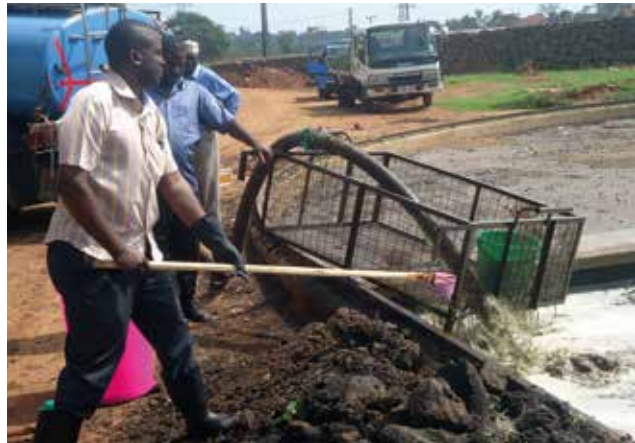
Figure 2.5 : Dégrillage de déchets solides de boues de vidange à l'entrée d'une station de traitement lors d'une campagne de prélèvement à Kampala, Ouganda (photo : Daniel Ddiba).
