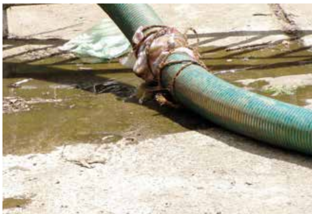
Figure 4.4 : Les tuyaux et accouplements doivent être régulièrement contrôlés et changés. Sur cette photographie, des boues fuient car la connexion n'est plus étanche (photo : David M. Robbins).
