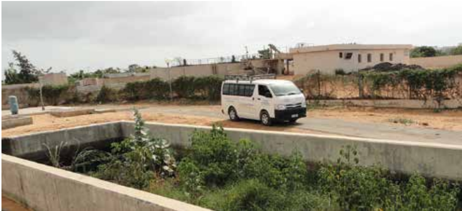
Figure 6.5 : Exemple d'exploitation-maintenance inadaptée d'un bassin de décantation et d'épaississement en Afrique de l'Ouest. La couche d'écume qui n'a pas été extraite depuis longtemps sert de support au développement de végétaux. Les volumes de boues et d'écume accumulés dans l'ouvrage ne permettent plus d'atteindre la performance escomptée et nécessitent des moyens plus importants pour le nettoyage (photo : Sandec).
