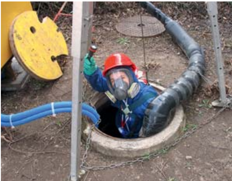
Lubomira Kovalova steigt in den Schacht des Kantonsspitals Baden, wo das Abwasser für die Pilotanlage entnommen wird.
