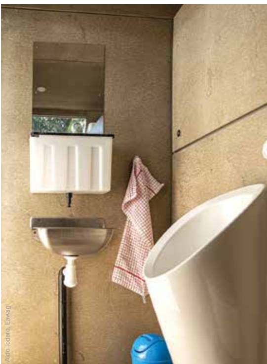
Ces toilettes n'ont rien à envier aux toilettes «normales» en matière de confort: les toilettes «Autarky» avec leur cuvette à séparation (non visible sur la photo), leur urinoir et leur lavabo.
