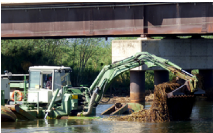
Les plantes aquatiques flottantes sont retirées sur un pont au-dessus de la centrale hydraulique «Kafue Gorge Power Station». (Photo: RS Winton)
