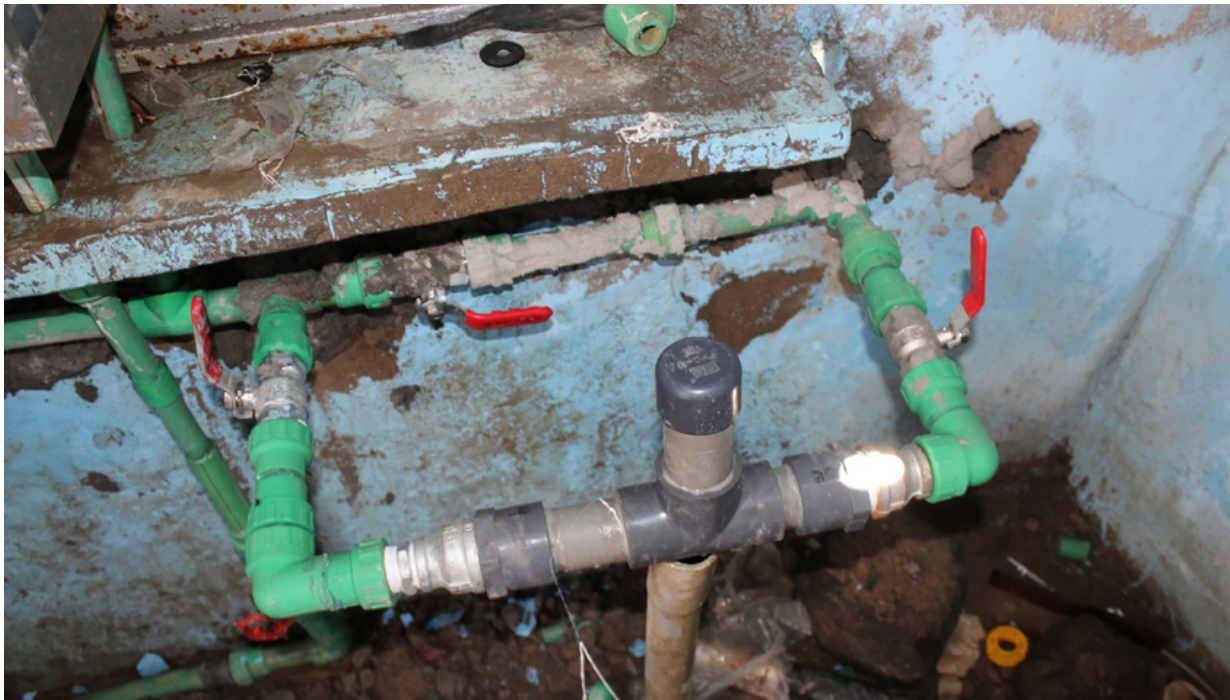
Système de chloration passif, fabriqué localement, installé dans un kiosque à eau au Kenya. (Photo: Lisa Appavou)
