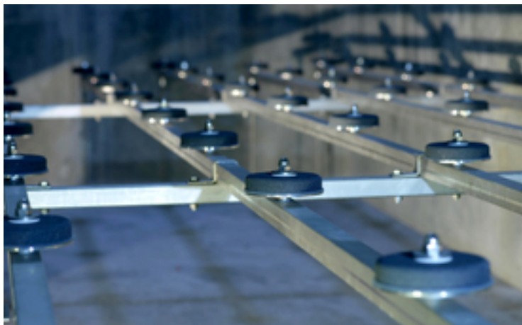
L'ozonation est une méthode éprouvée pour éliminer les composés traces organiques de l'eau. Sur la photo: des diffuseurs d'ozone à la STEP Neugut de Dübendorf. (Photo: Aldo Todaro, Eawag)
