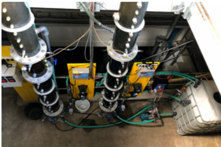
Essais pilotes de filtration sur CAG à la STEP de Muri (photo : Eawag).
